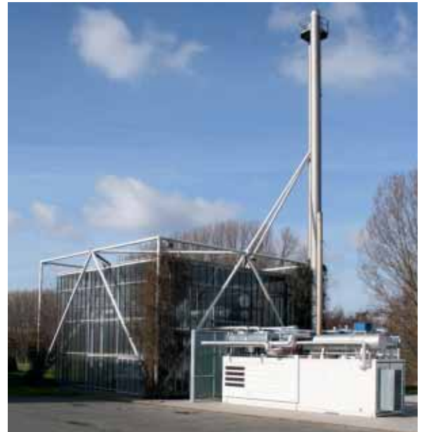
Neues Blockheizkraftwerk mit Kraft-Wärme-Kopplung, 2008
